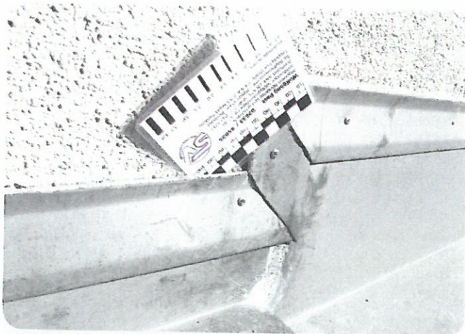
Im Bild: Kittleiste am WDVS genietet, abgelöste Kittfuge. Wassereinlauf von oben ist ungehindert möglich.
