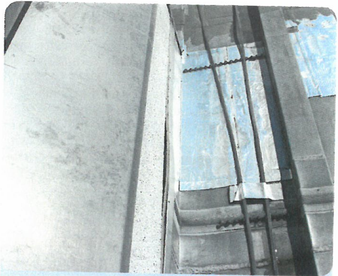
Im Bild: Durch Wärmedehnung ausgerissene Spreizniete aus dem WDVS, Kittfuge ebenso abgelöst, ungehinderter Wassereinfluss.
