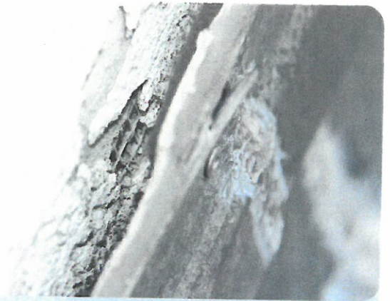
Im Bild zu sehen: Die erhebliche Beschädigung des WDVS durch die ausgerissene Spreizniete.
